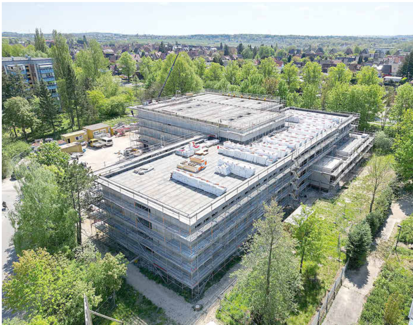
Blick auf den Neubau. Im Vorbau unten rechts entsteht eine Mensa mit 100 Innen- und Außenplätzen.
