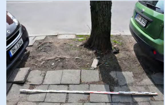
oberflächennahe Wurzelbildung, Anhebung der Flächenbefestigung
