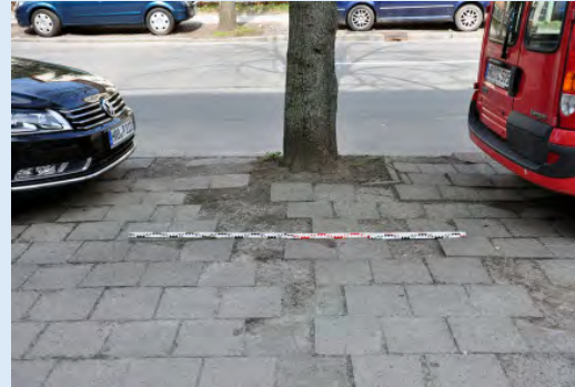
Baumscheiben zu klein + verdichtet
