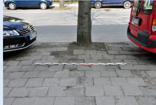
Baumscheiben zu klein + verdichtet
