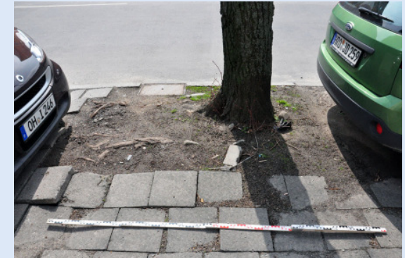
oberflächennahe Wurzelbildung, Anhebung der Flächenbefestigung
