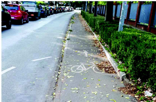
Bild 3: Zu geringe Radwegbreite Zufahrt Kopernikusstr. (Ost)
