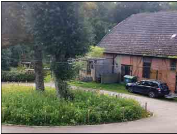
Abb. 75: sanierungsbedürftiges Nebengebäude auf dem Forsthof Wiethagen
