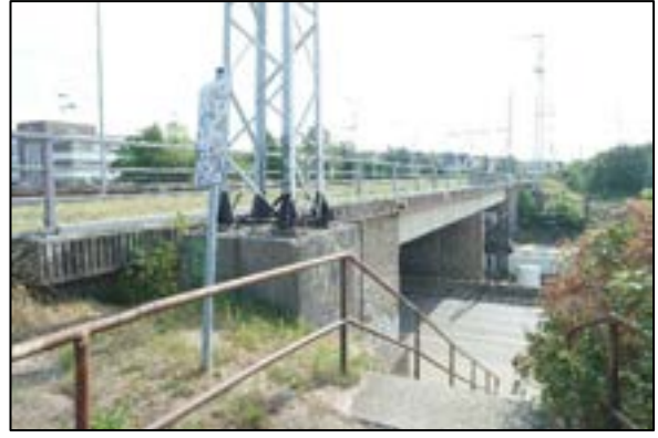
Abbildung 3: EÜ Goetheplatz, Nordseite [34]
