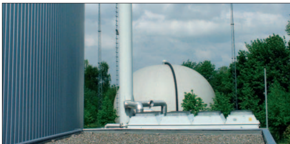
BHKW im Klärwerk Bramow mit Klärgassammler, Faulturm und Motorenanlage
