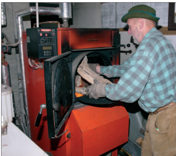
Das Forstamtgebäude nutzt eine Holzvergaserheizung.
