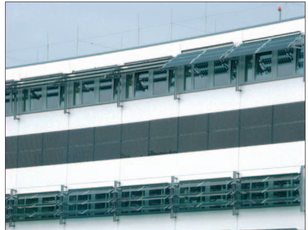
Südstadt Krankenhaus, Verschattung mit PV-Elementen
