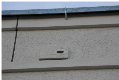
Mauerseglernistkasten (Aufsatzkasten) an einem Rostocker Plattenbau
