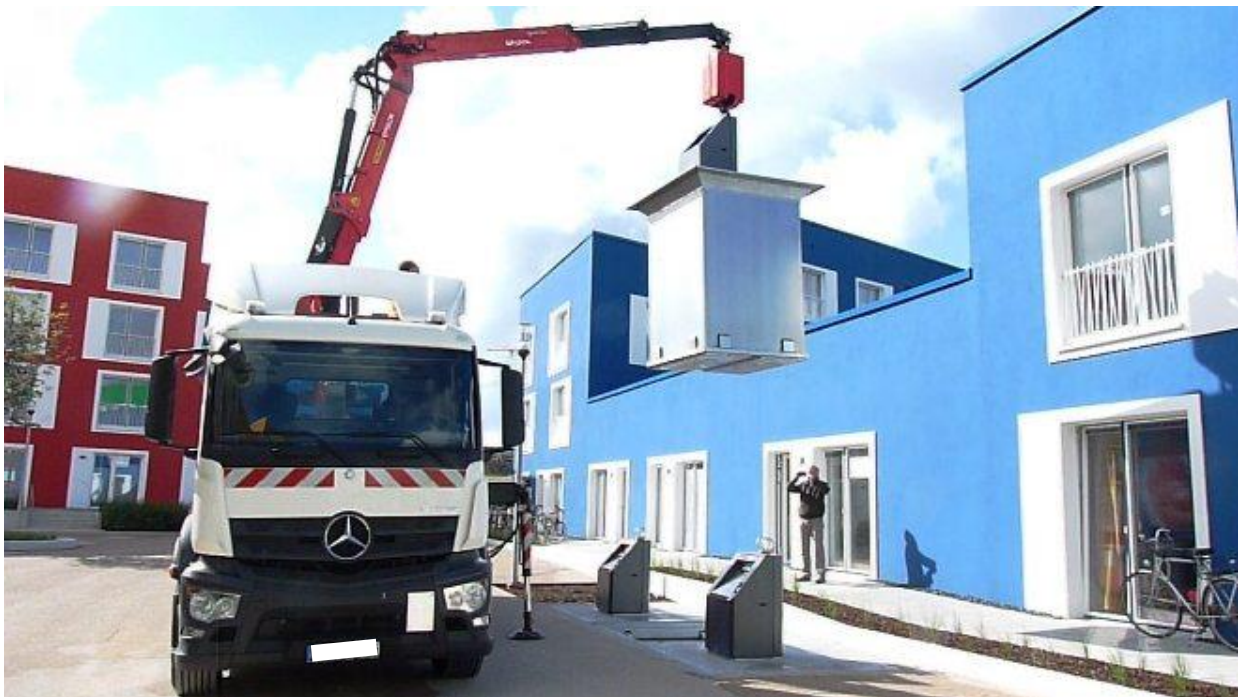
Entnahme des Abfallcontainers aus dem Unterflursystem durch ein Entsorgungsfahrzeug mit ausgefahrenen Stützfüßen. (4)
