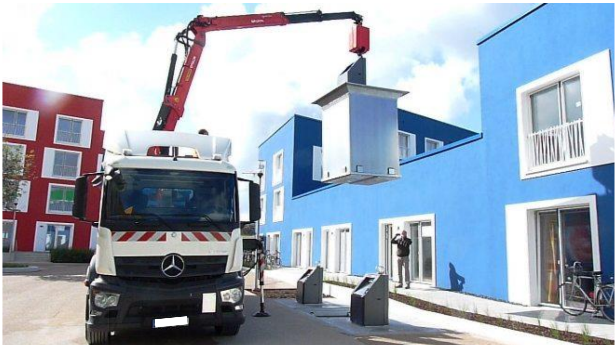
Entnahme des Abfallcontainers aus dem Unterflursystem durch ein Entsorgungsfahrzeug mit ausgefahrenen Stützfüßen. (4)
