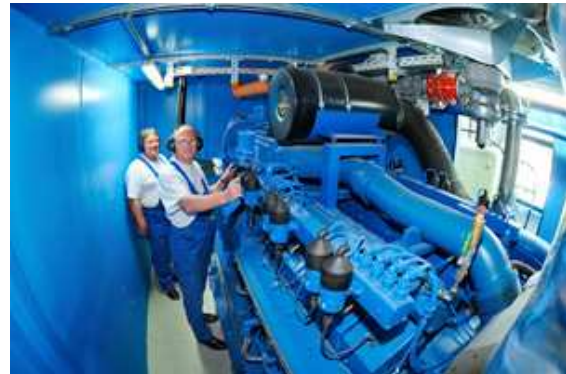
Foto: Klärgas-BHKW Eurawasser GmbH in Rostock
