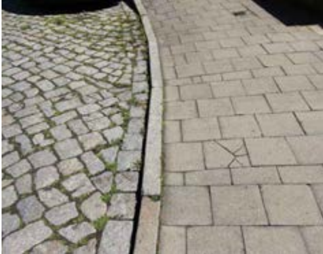
Abb. 53. Unebenheiten und mangelnde Bordsteinabsenkung in der Adolf-Becker-Straße
