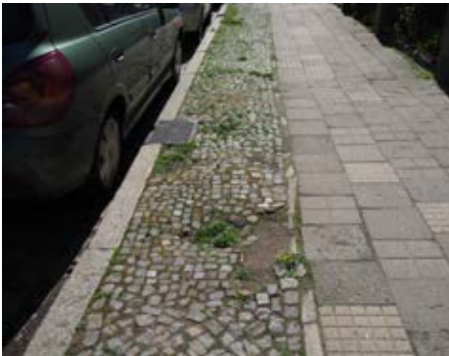
Abb. 54. Unebener Gehweg in der Gewettstraße
