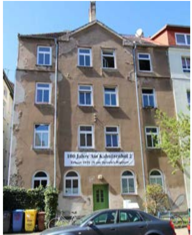
Abb. 34. Sanierungsbedürftiges Gebäude im Kabutzenhof
