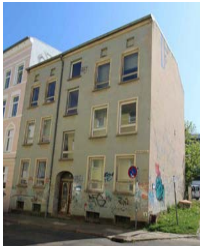
Abb. 35. Sanierungsbedürftiges Gebäude in der Windmühlenstraße
