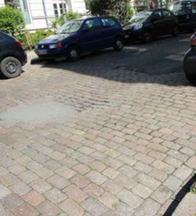
Abb. 61. Bodenwellen in der Fahrbahn der Borwinstraße
