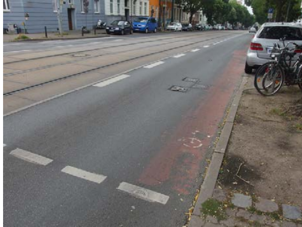
4 Verblässende Markierung Radfahrstreifen
