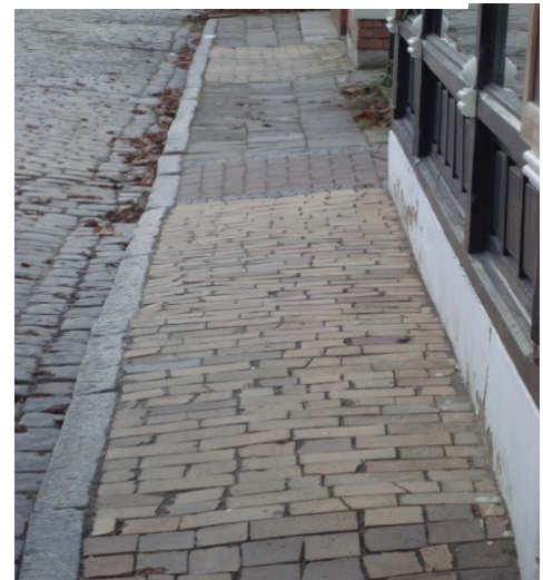
Beschädigter Gehweg, Absenkungen und Materialwechsel in der Alexandrinendstraße
