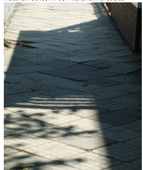
Beschädigter Gehweg in der Anastasiastraße
