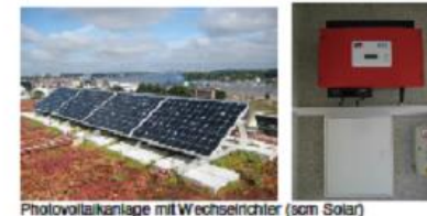
Photovoltaikanlage mit Wechselrichter (sow Solar)
