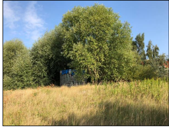
Abbildung 6: Trafostation umgeben von Weidengehölzen (Vor Ort Begehung 15.05.2018)
