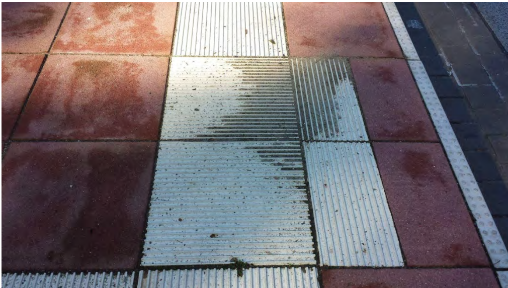
Rippenplatten müssen frei von Sand und Unrat sein, sonst ohne Funktion hier Einstiegsfeld (vor 2024)
