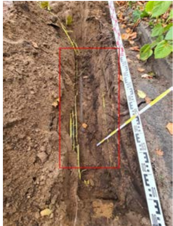
Abbildung 08: Fährberg, D-18147 Rostock. Rot markiert: Baumnummer 27 mit Schwachanteilen in der Oberschicht sowie Erdkabel ab einer Tiefe von 50 cm. (BECKER, M., 09. NOVEMBER 2020).
