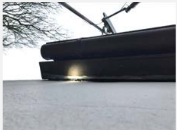
Abbildung 8: Gebäude 1 (Spalte Dachkasten)
