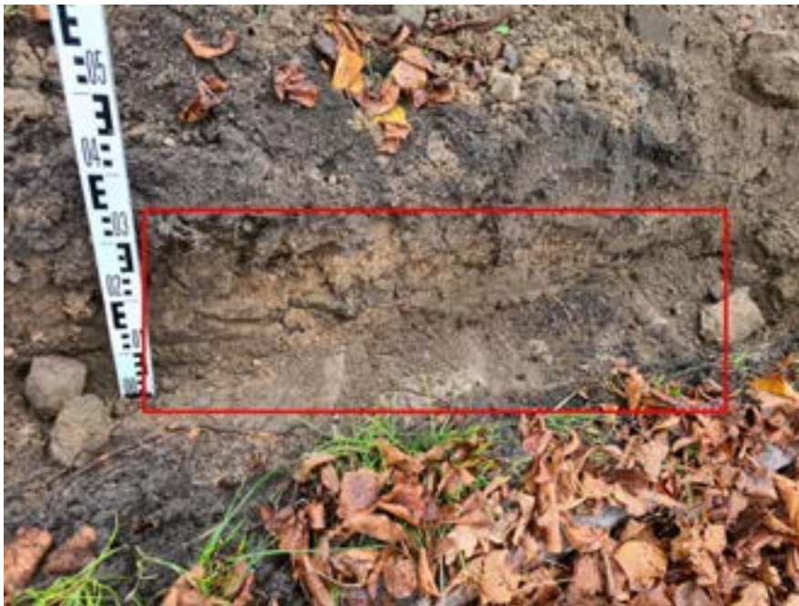
Abbildung 20: Fährberg, D-18147 Rostock. Rot markiert: Baumnummer 10 - Darstellung der signifikant verringerten Wurzelanteilen durch ein- gebaute Mauer- schächte und Lei- tungen ab einer Bodentiefe von ca. 50 cm. Fein- wurzelstrukturen unterhalb der Grasnarbe (BECKER, M., 25. NOVEMBER 2020).
