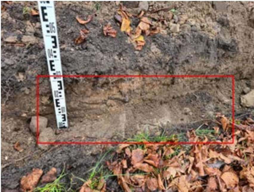
Abbildung 02: Fährberg, D-18147 Rostock. Rot markiert: Mauer- werk mit Leitungen ab einer Tiefe von ca. 50 cm an Baumnummer 08. (BECKER, M., 25. NO- VEMBER 2020).
