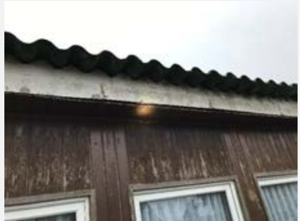
Abbildung 13: Gebäude 4 (Einschlupf Dachkasten)
