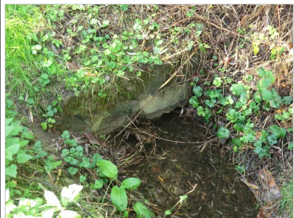
Auslauf der Rohrleitung, stark verlandet
