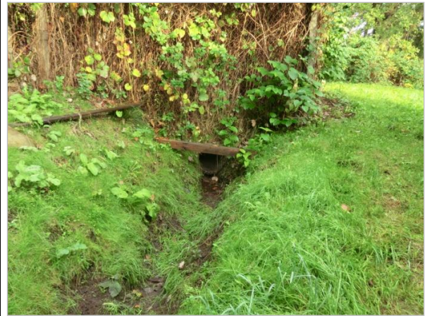
Durchlass in der Kleingartenanlage „Groter Pohl“
