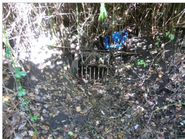
Einlauf der Rohrleitung nahe Feuerwehr, DN800
