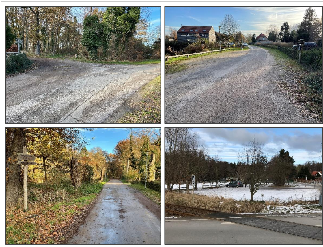
Abb. 98: Von links oben nach rechts unten: Foto 1 + 2: Erneuerungsbedürftiger Straßenraum Dorfstraße Wiethagen; Foto 3: umweltfreundlicher Ausbesserungs-/ Erneuerungsbedarf Straßenabschnitt Wiethagen bis zum Forstamt; Foto 4: Parkplatz am Köhlerhof und dem potenziellen DB-Haltepunkt Wiethagen. Aufnahmen: BSR (2022); vgl. auch Abb. 80.
