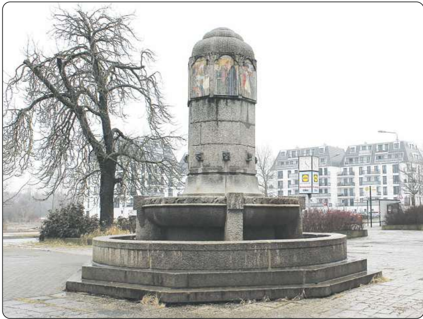
Der Brinckman-Brunnen und die Freifläche darum benötigt dringend eine Generalsanierung, so die Forderung des Ortsbeirates.
