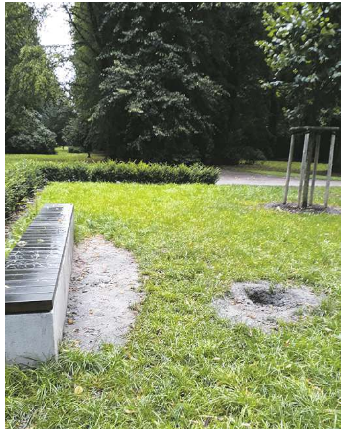
Die tiefen Löcher sind beim Betreten der Rasenflächen eine große Verletzungsgefahr.
