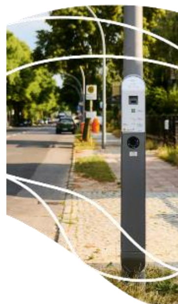
Abb. 12: Mastsäule mit integrierter Ladestation (ubitrlicity GmbH)
