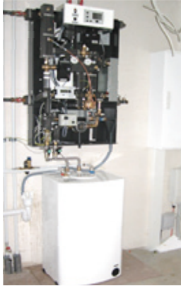
Beispiel FW-Übergabestation im EFH
